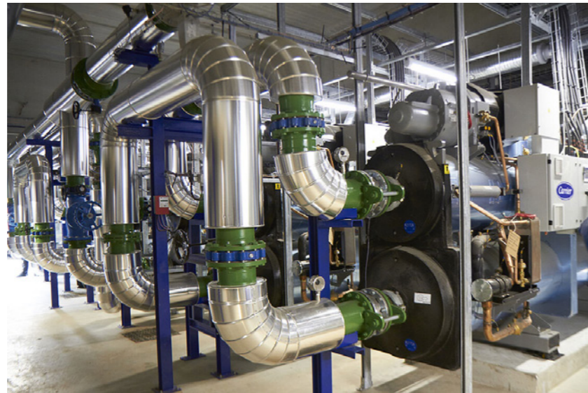
↑ À l'intérieur d'une centrale de géothermie, des pompes à chaleur permettent de rehausser la température de l'eau si nécessaire.
